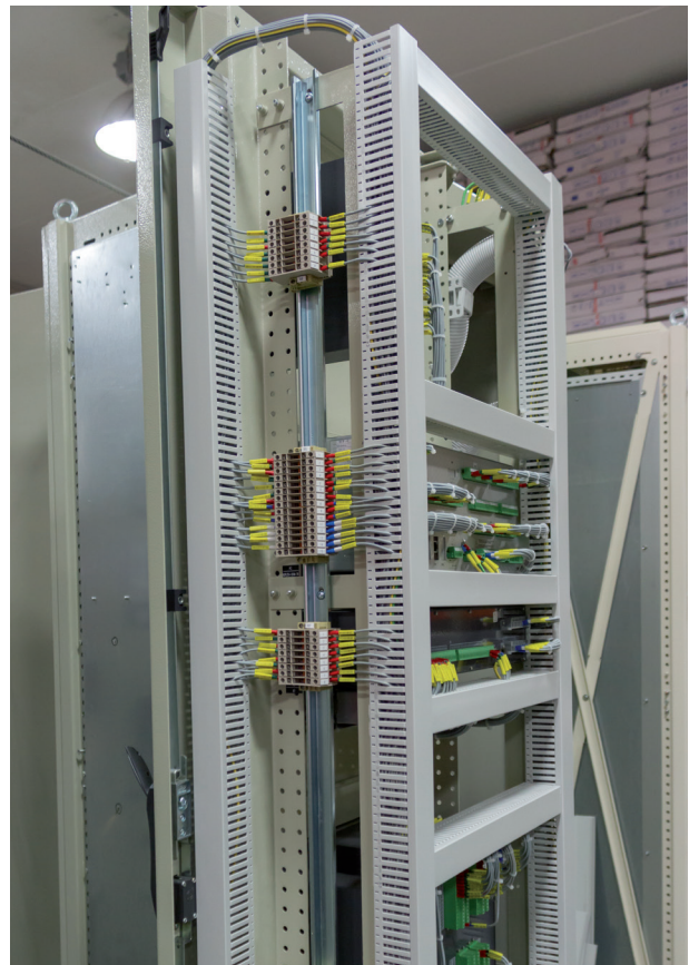
Energieerzeugung und -verteilung
