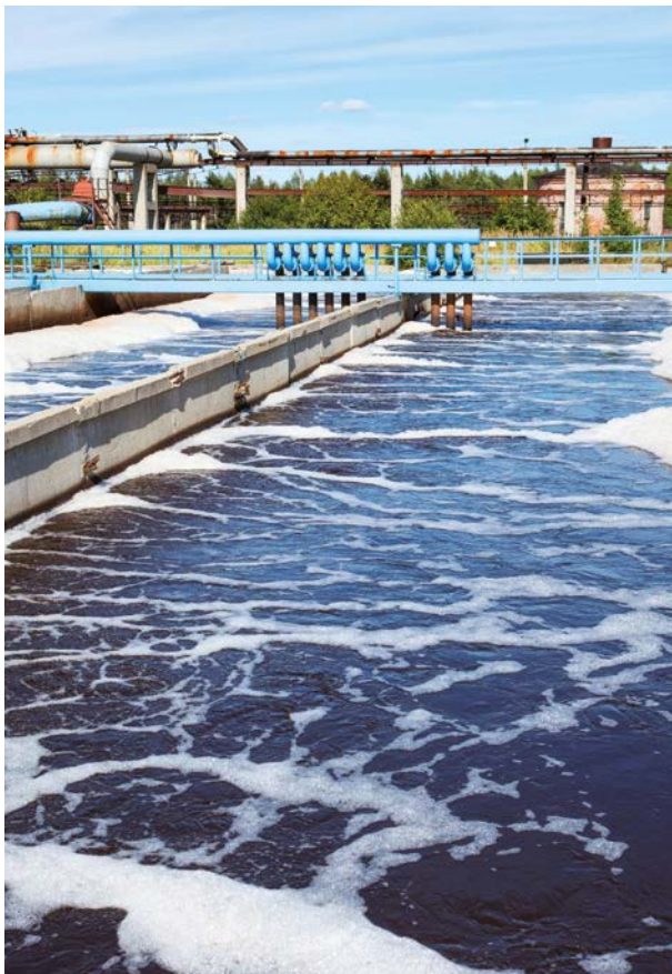
Traitement de l'eau
