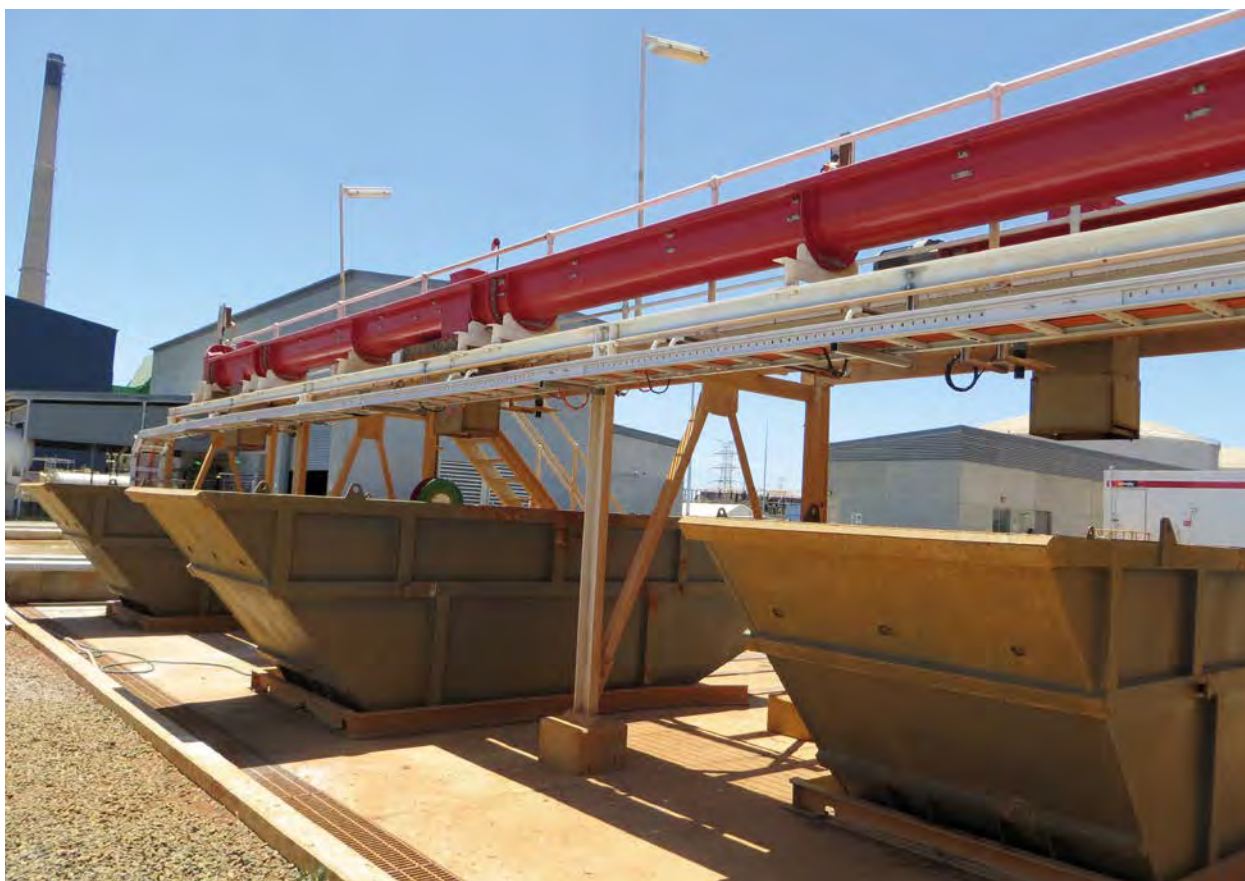
Пречистване на водата: инсталация за обезсоляване
