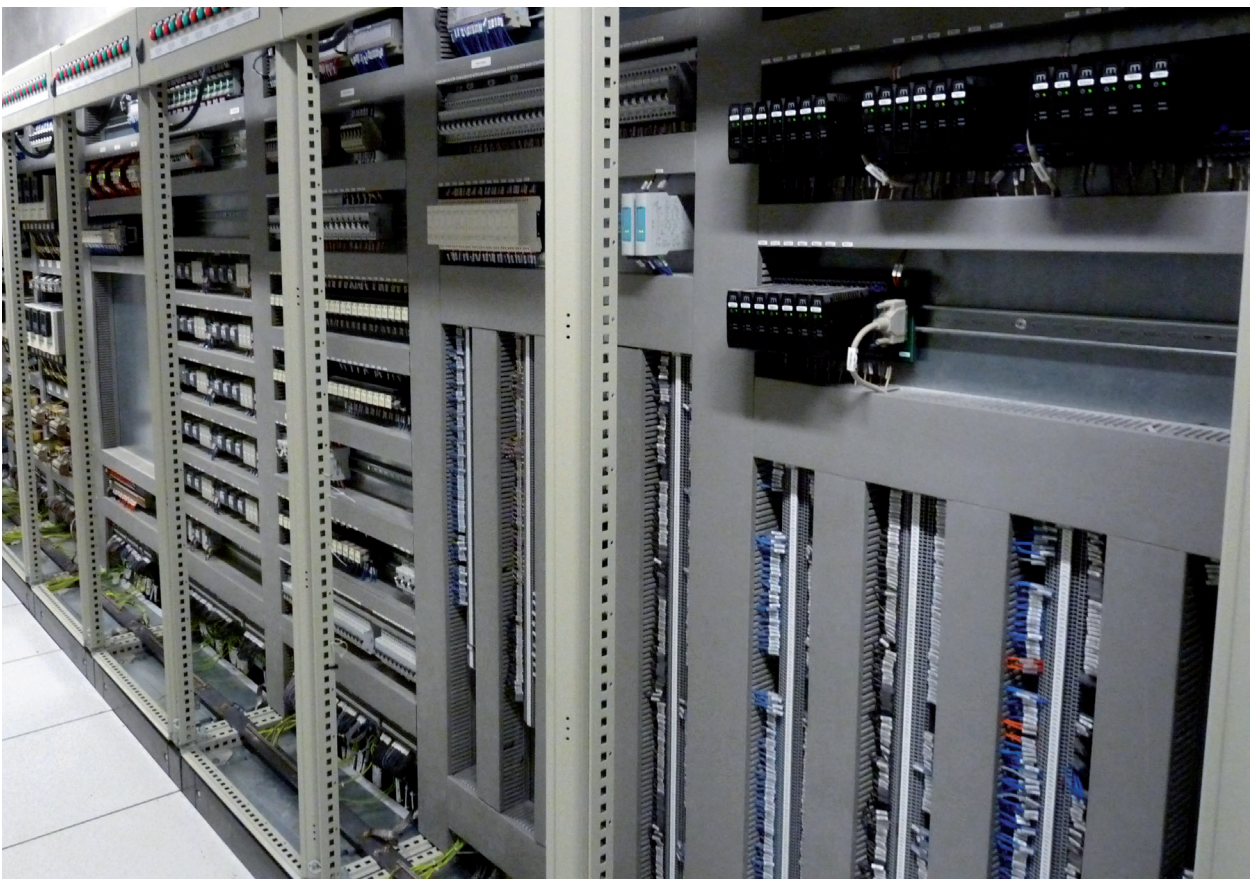
Tratamiento de aguas
