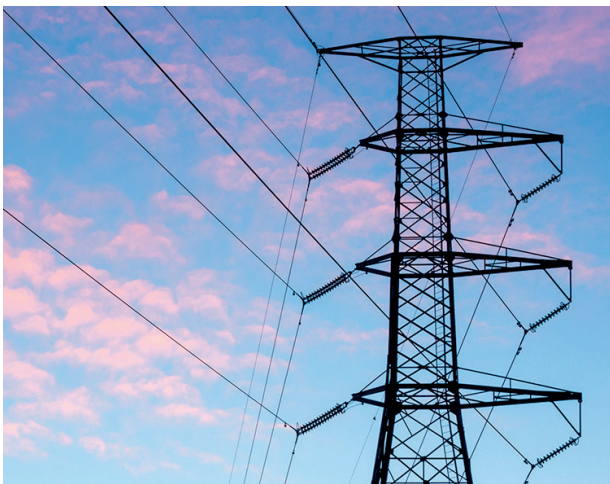
Redes de distribuição de energia elétrica
