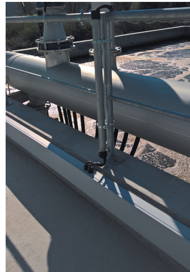
Tratamento de águas: ETAR
