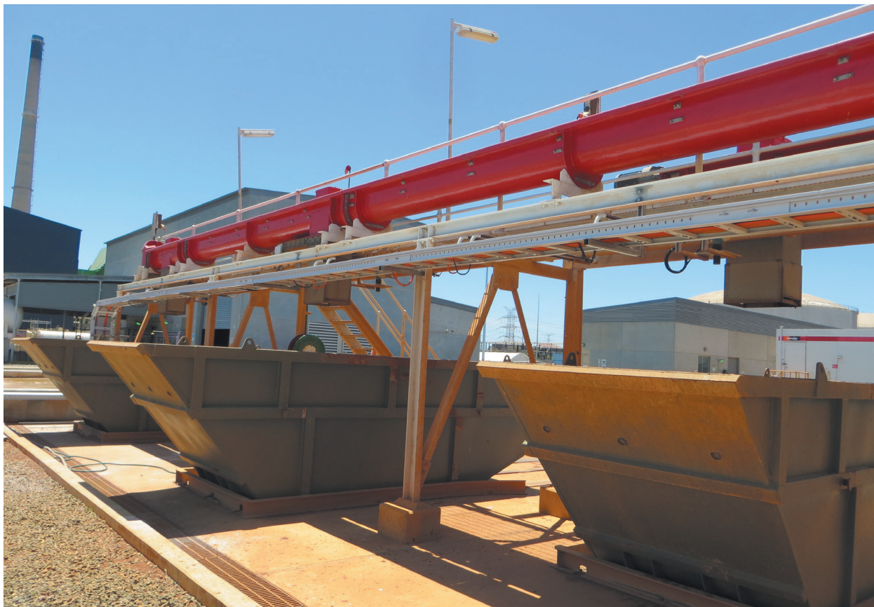
Tratamento de águas: estação dessalinizadora
