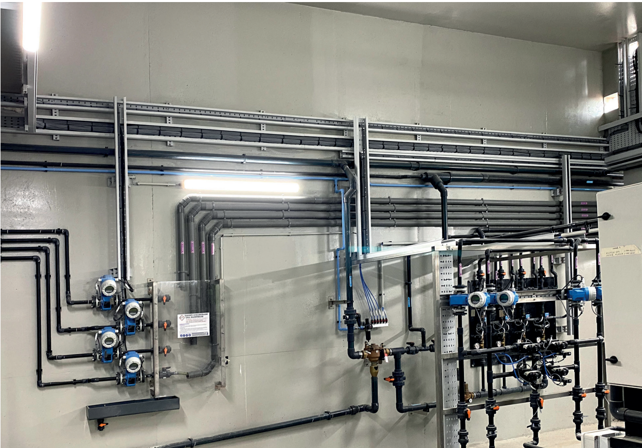
Tratamento de águas
