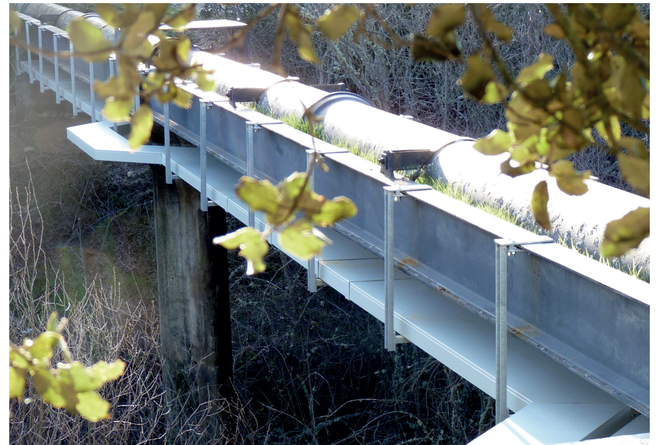
Produção e distribuição de energia elétrica
