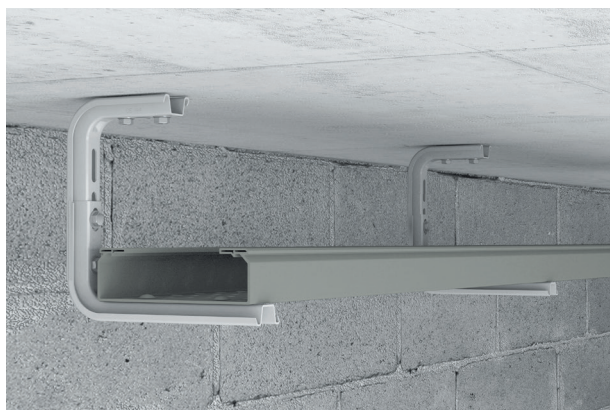
Dos soportes L en acero galvanizado con pintura epoxy gris.
