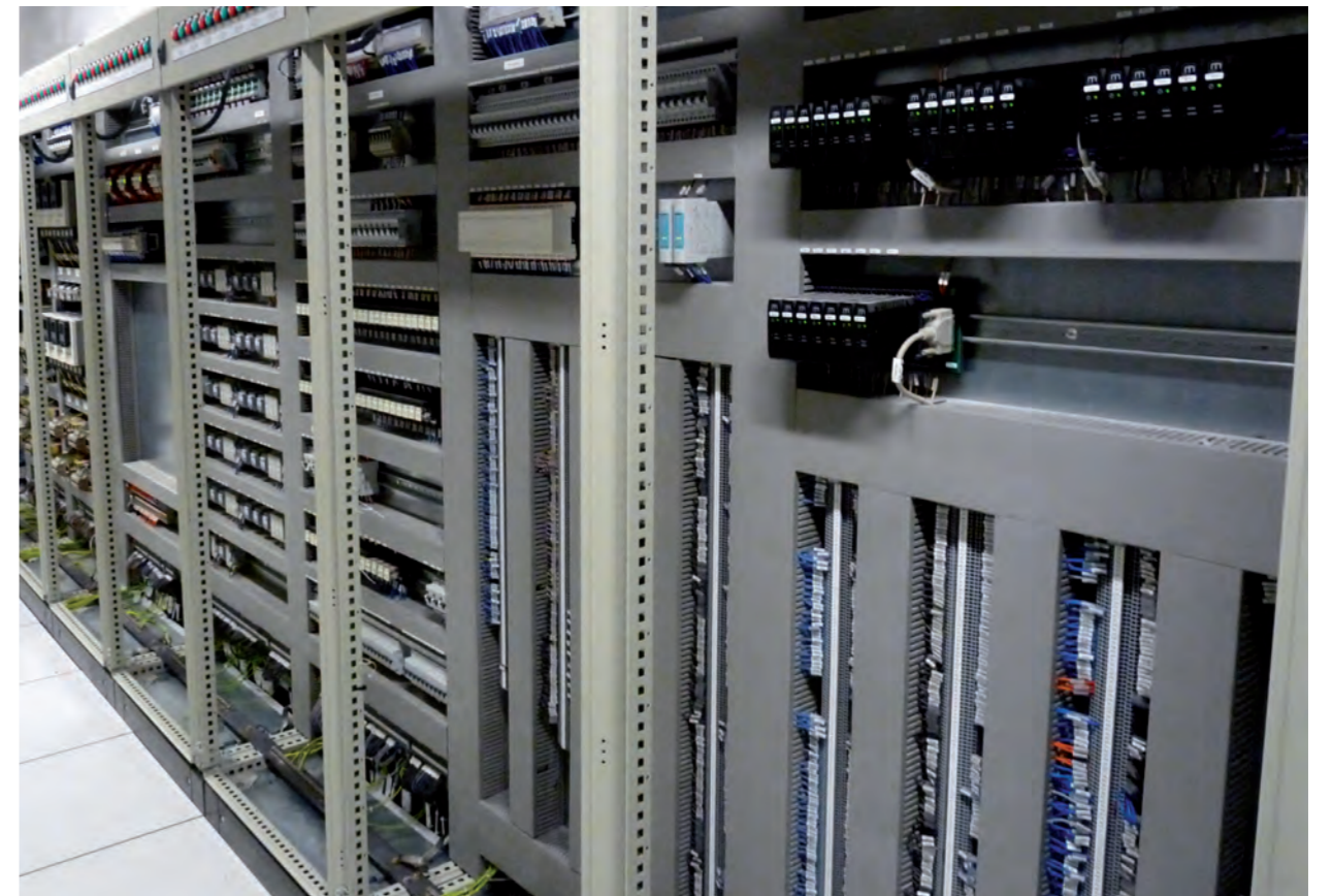
Tratamiento de aguas
