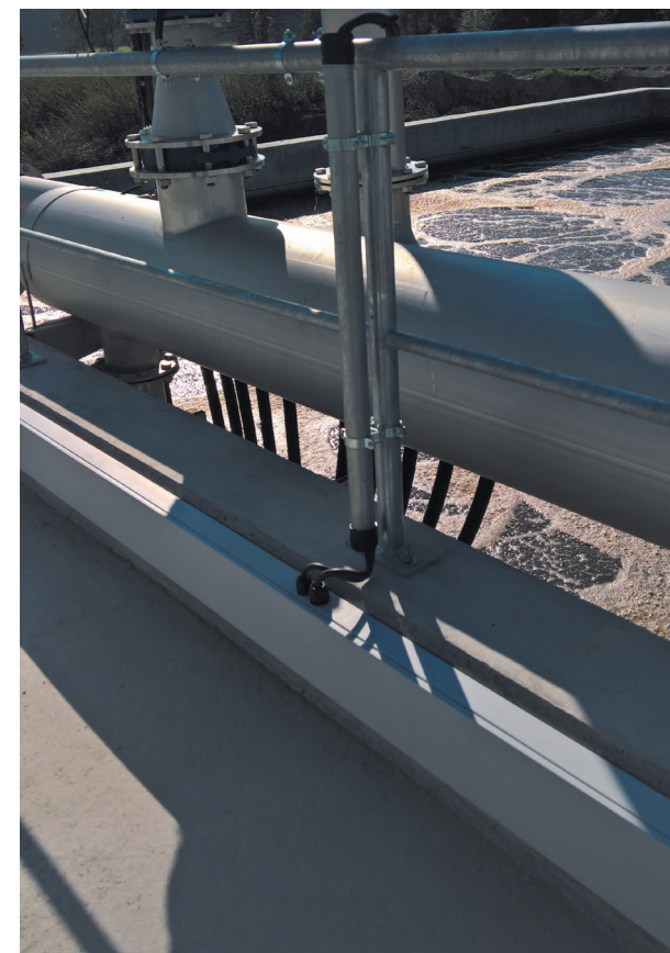
Tratamiento de aguas: EDAR
