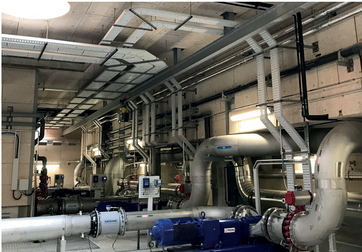
Traitement des eaux
