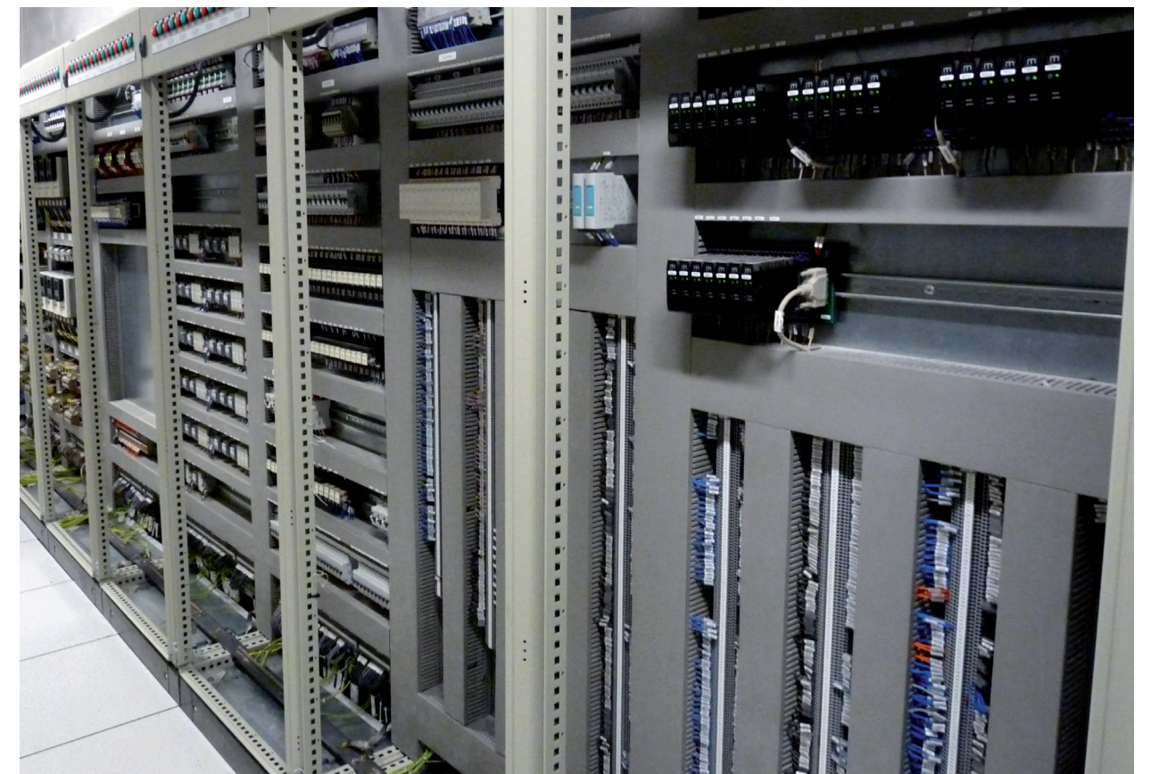
Traitement de l'eau
