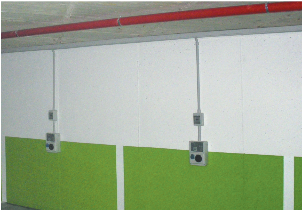
Parc de stationnement : véhicule électrique
