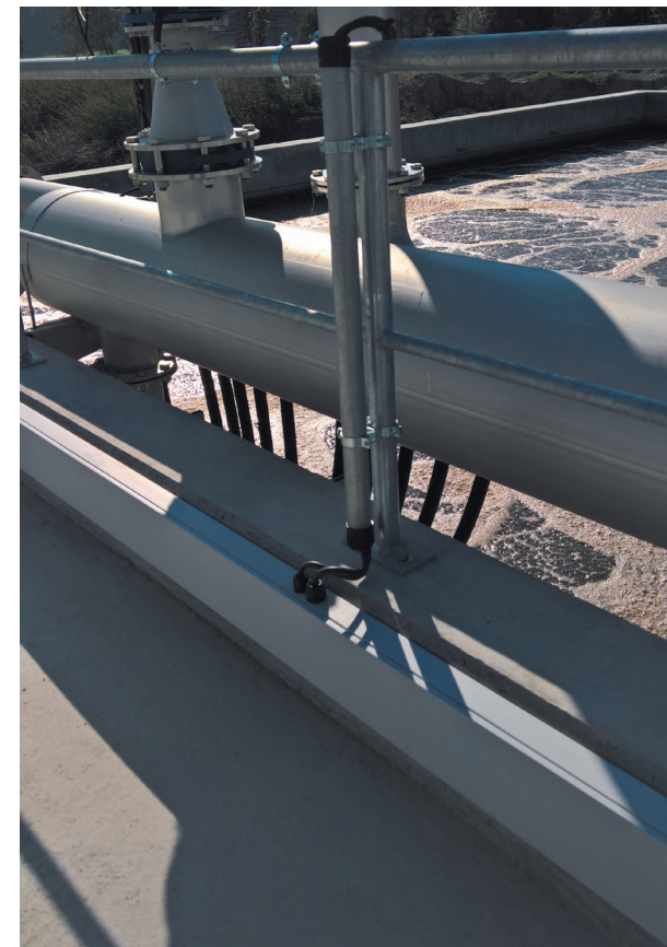
Traitement des eaux : Station d'épuration
