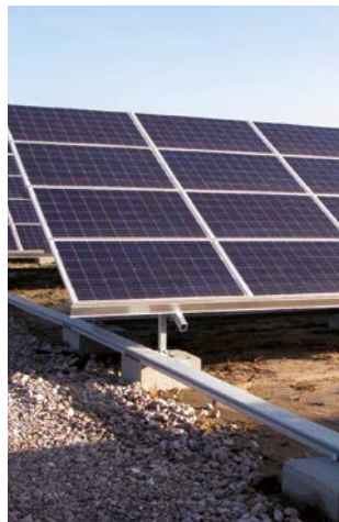
PV配線構造、スペイン
