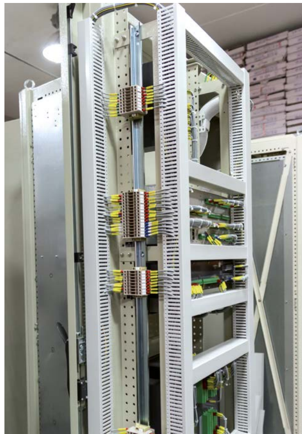
Produzione e distribuzione di energia elettrica
