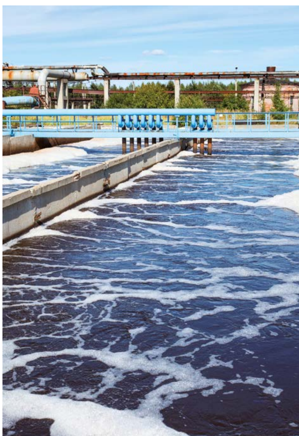
Infrastrutture: trattamento acqua
