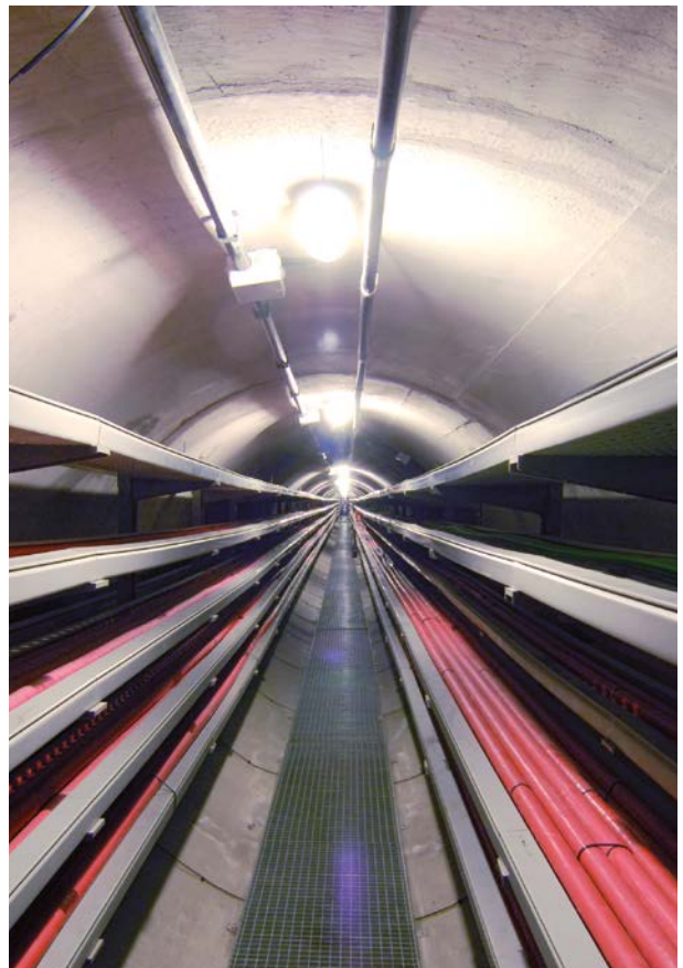
Port lotniczy: tunel kablowy
