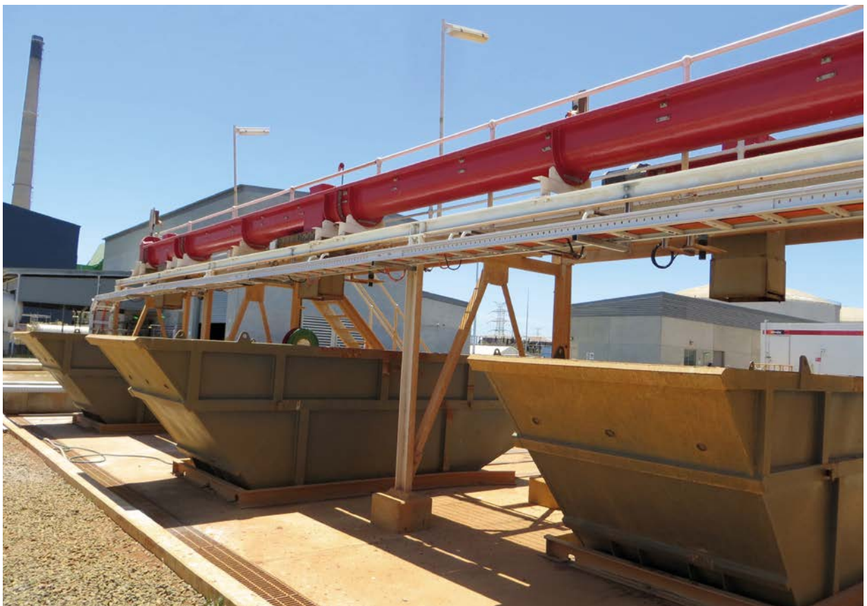
Oczyszczalnie ścieków: stacja odsalania wody
