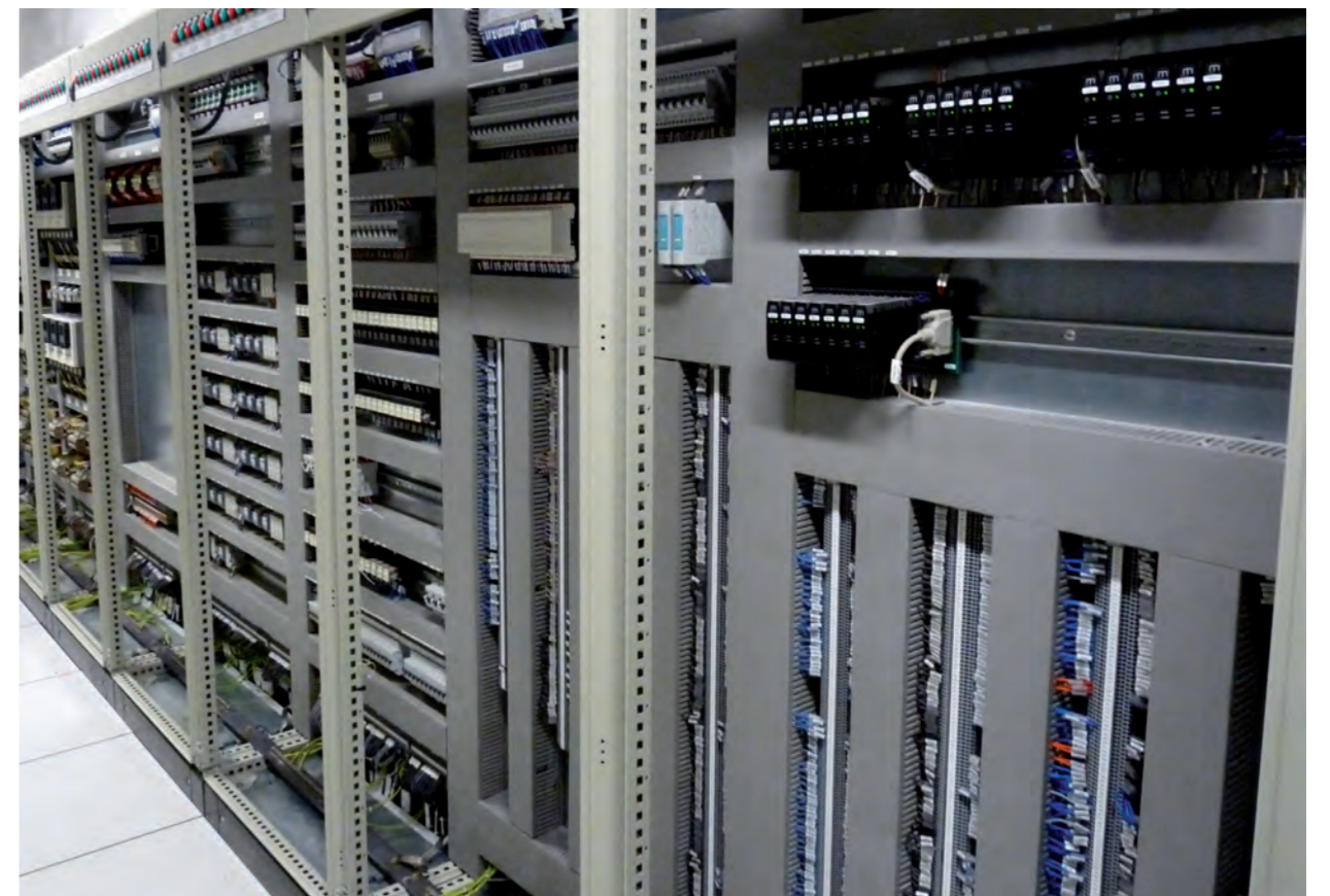
Tratamento de águas
