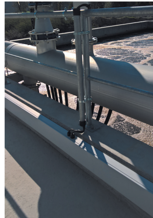
Tratamento de águas: ETAR
