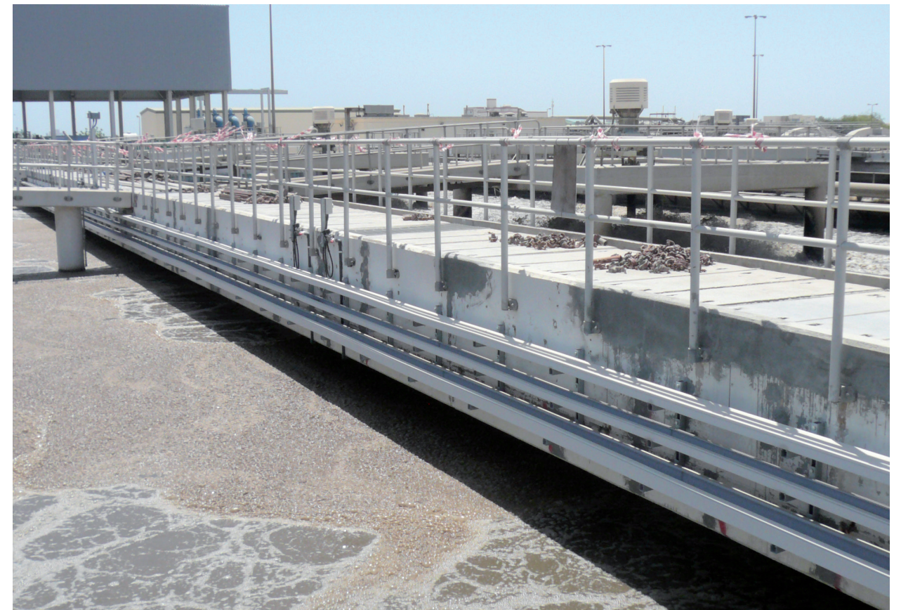
Tratamento de águas: ETAR
