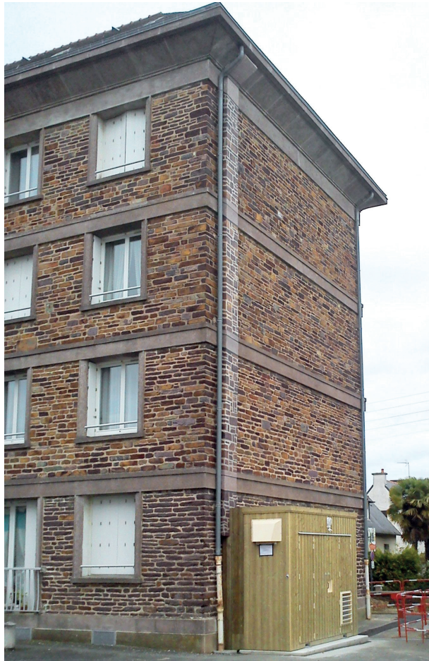
Distribuição vertical dos cabos através de Caminho de cabos 66 com tampa pintada, minimizando o impacto visual.
