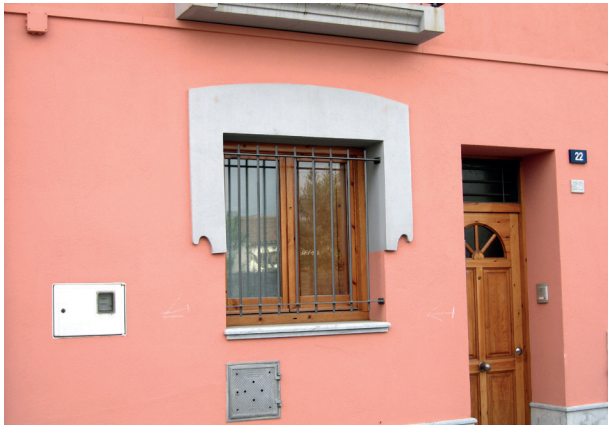
Distribuição de energia em edifícios de habitação através de moldura.
